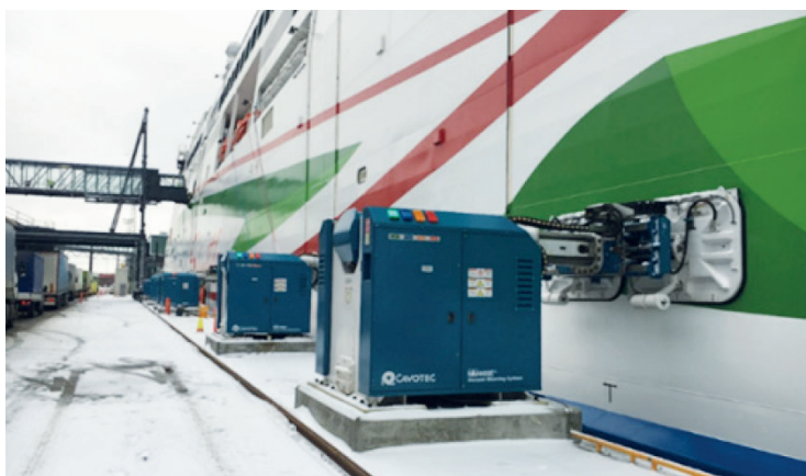
Рис. 8. Вакуумное автошвартовочное устройство, установленное на причальном сооружении (Заимствовано из общедоступных ресурсов интернета)
