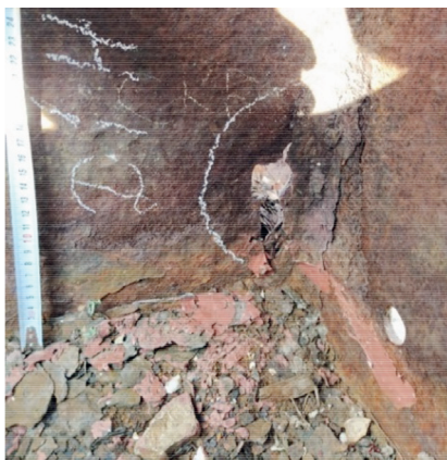
Рис. 4. Сквозная коррозия в силовом элементе затвора
