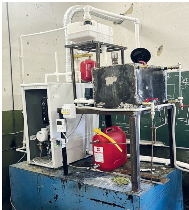
Рис. 4. Общий вид лабораторного стенда с котлом Kiturami TURBO-17
