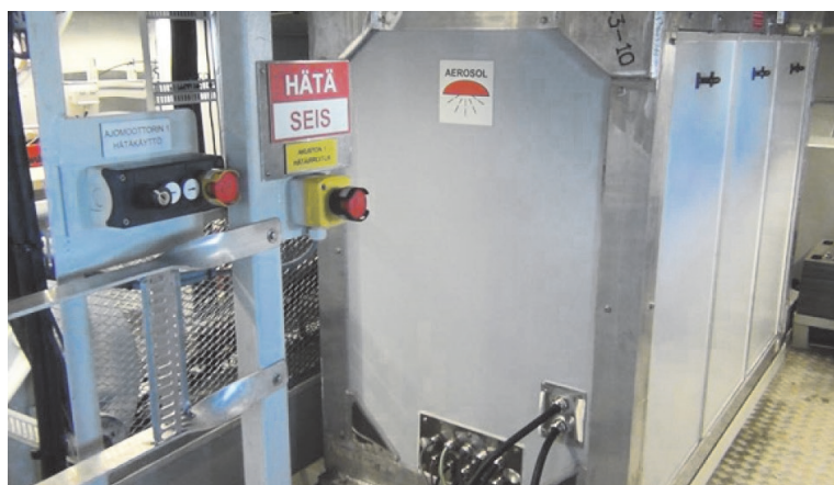
Рис. 4. Блок пропульсивных аккумуляторных батарей в машинном отделении судна
